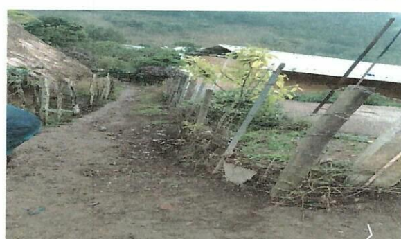
Foto 4: Se realizará mejoras en la parte derecha de la escuela debido a que no se cuenta con un muro perimetral adecuado todo el contorno del centro educativo no cuenta con muro perimetral
